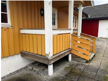
Terrasse til inngangsparti med manglende vedlikehold.
