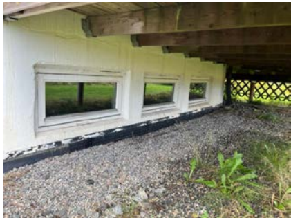
Synlig grunnmursplast mot vest.
