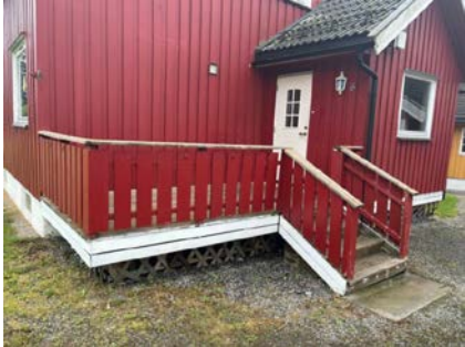
Terrasse til inngangsparti har manglende vedlikehold.
