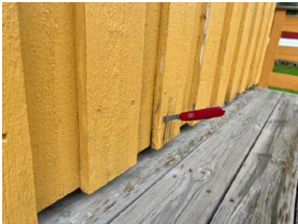
Råteskader i enkelte bord.
