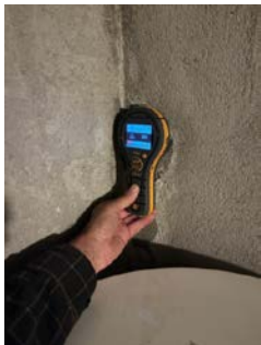
Fuktsøk på nord/østre hjørne viste unormale verdier.
