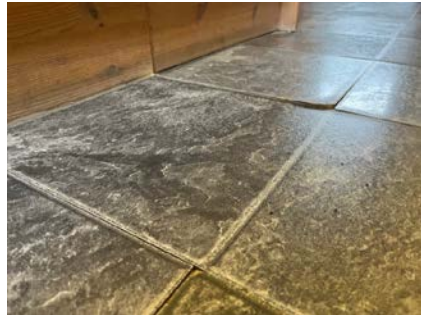
Kjøkkengulv med skader.
