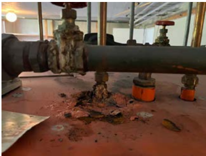
Rust på topp av kjele.
