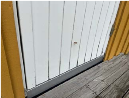
Terrassedør har fuktskader.
