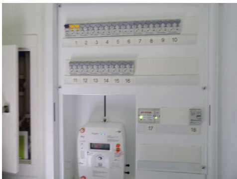
Sikringsskap i utvendig bod
