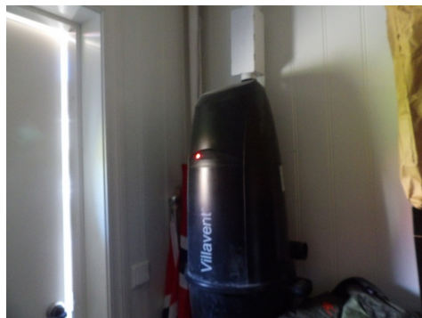
Sentralstøvsuger i utvendig bod.
