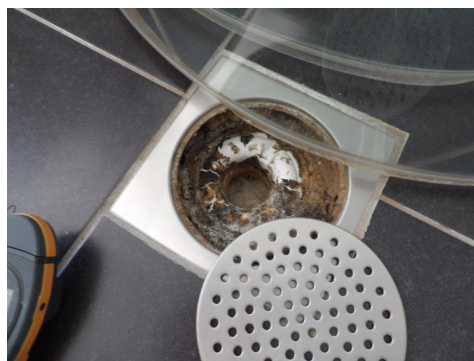
Plastsluk i dusjsone.
