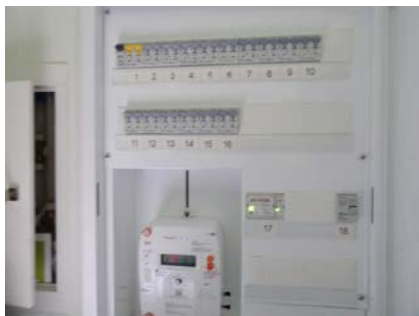
Sikringsskap i utvendig bod
