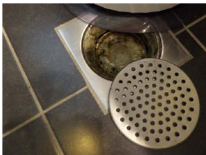
Plastsluk i dusjsone.
