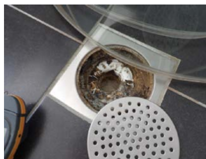
Plastsluk i dusjsone.
