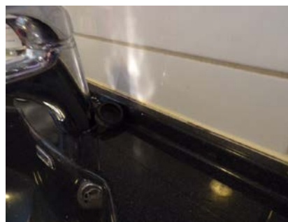
Slitt fuger ved servant.
