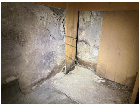
Synlige tegn på fukt i kjeller fra terreng.
