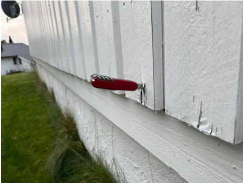
Råteskader i kledning.
