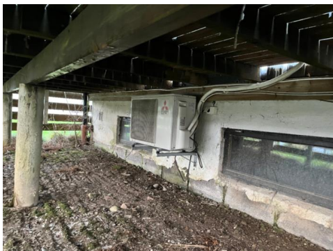
Vann fra utedel til varmepumpe må ledes vekk fra bygning.
