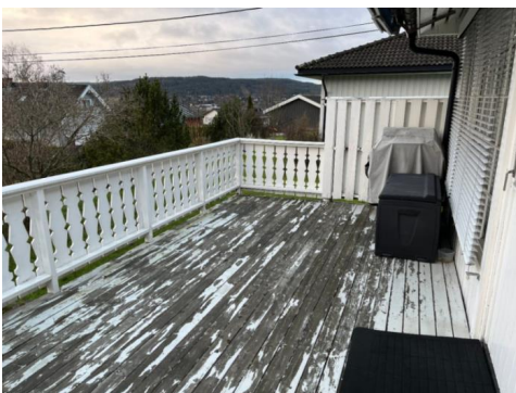
Veranda med sterk slitasje.
