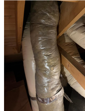
Det er vurdert at dette er avløpslufting for avløp.
