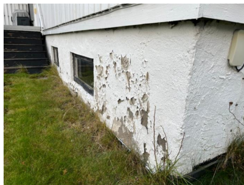
Grunnmur har løs puss/maling.
