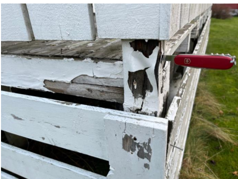
Råte i konstruksjon.
