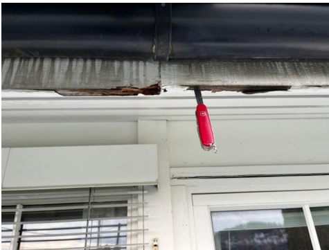
Råteskade i forkantbord.
