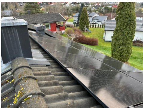
Solcellepanel på en takflate mot sør.
