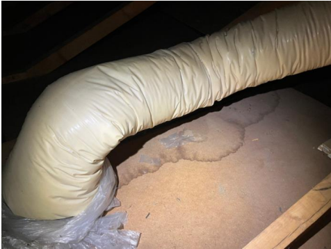
Fuktmerker under kanaler.
