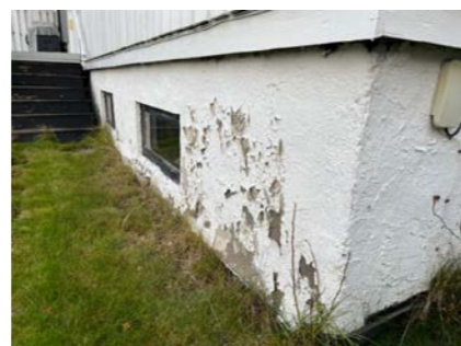
Grunnmur har løs puss/maling.
