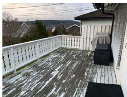
Veranda med sterk slitasje.
