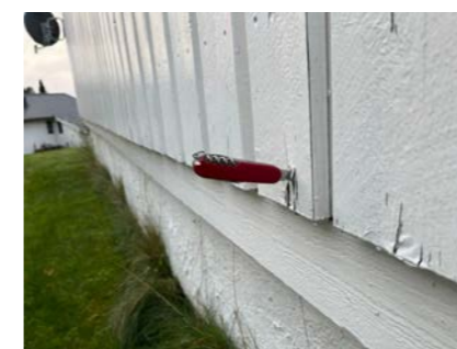
Råteskader i kledning.
