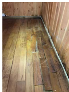
Parkett og vegg i bod har store fuktskader.
