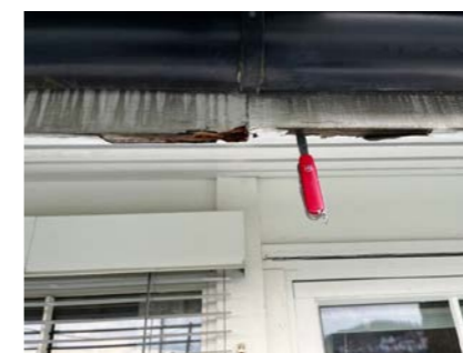
Råteskade i forkantbord.
