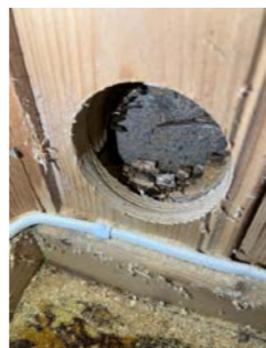
Hulltaking i sør/vestre hjørne av kjellerstue viste råteskader i utforing.
