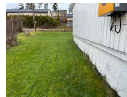
Terreng med fall mot bygning.
