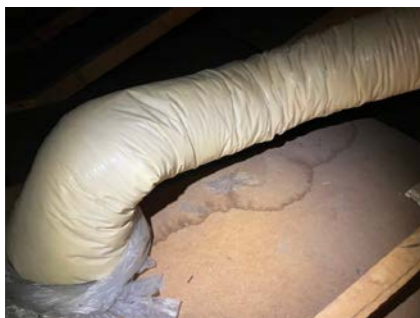
Fuktmerker under kanaler.
