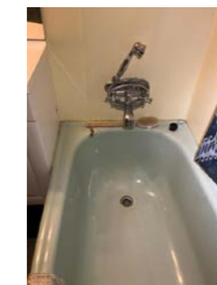
Det anbefales ikke bruk av dusj/badekar før våtrommet er renoveret eller etablert kabinett.
