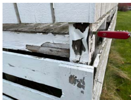
Råte i konstruksjon.
