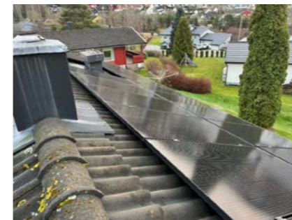
Solcellepanel på en takflate mot sør.
