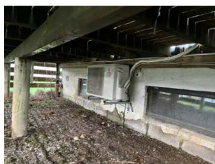
Vann fra utedel til varmepumpe må ledes vekk fra bygning.
