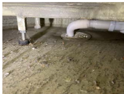
Sluk under kabinett.
