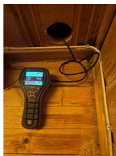
Fuktmåling nord/vestre hjørne av peisestue viste høye fuktverdier.
