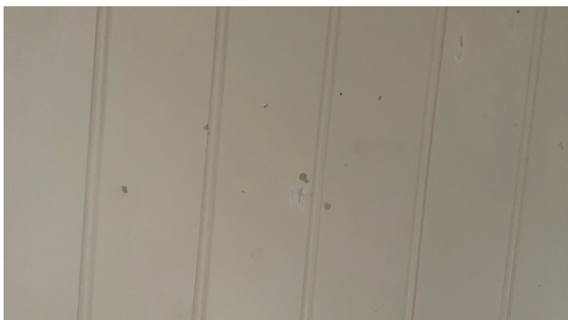
Sår/skader i veggplater.
