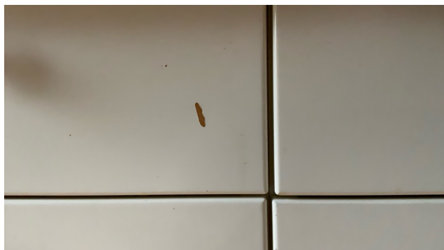
Eksempel på skader/sår i kjøkkenfronter.
