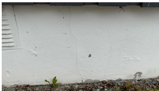
Eksempel på sprekk i grunnmur.
