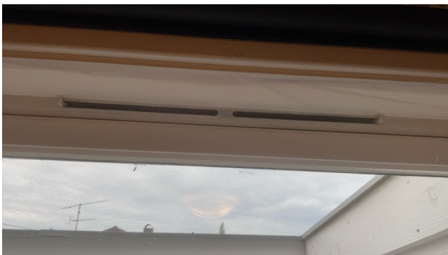
Ventiler i vindu.
