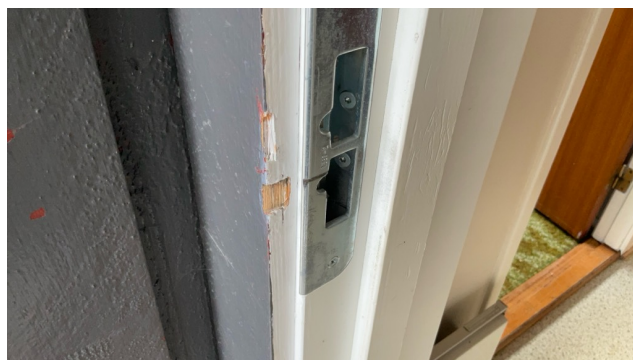
Skade i omramming.
