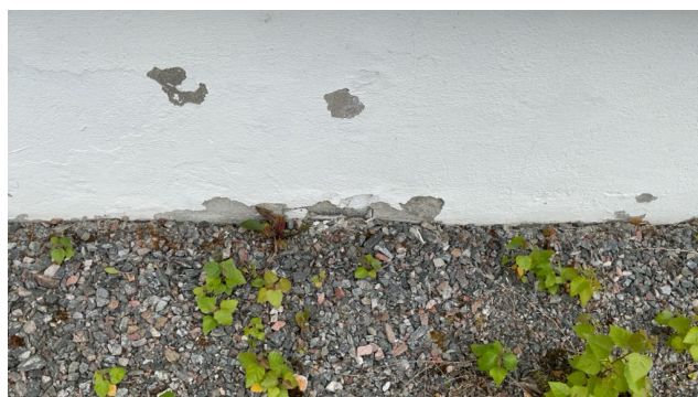
Eksempel på at puss har løsnet.
