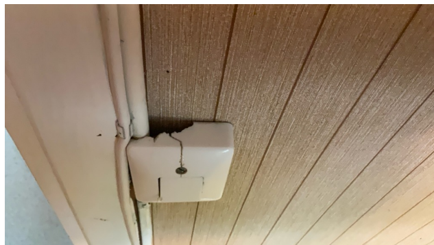
Lysbryter er defekt.
