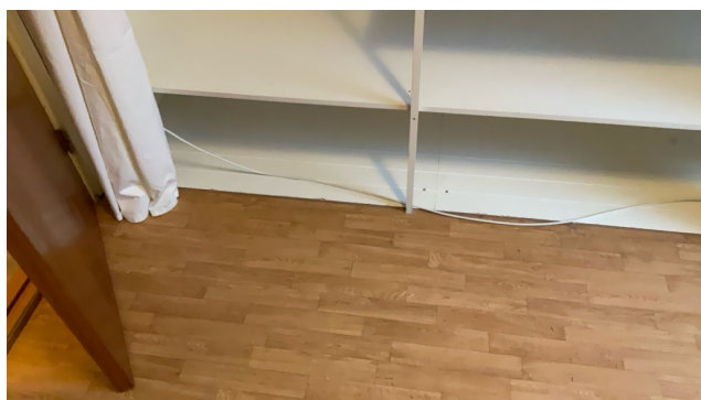
Kabel ikke festet.
