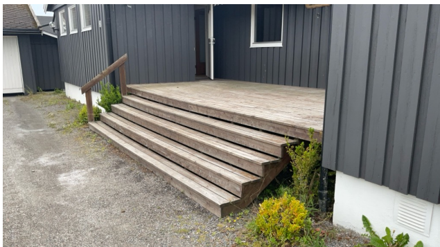
Trapp mangler rekkverk.
