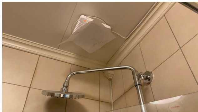
Ark henger på avtrekksventil. Bra avtrekk.
