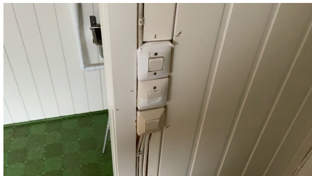
Skadede brytere er tapet over.
