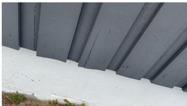
Eksempel på sprekker i kledning.
