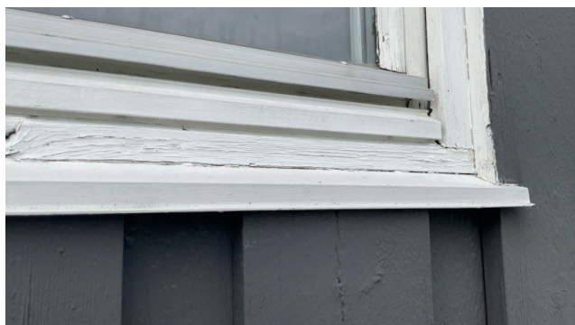
Eksempel på sprekker i trevirke.
