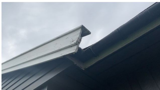
Eksempel på råteskader i vindskier/isbord.
