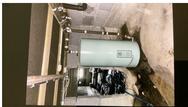
Bereder montert i krypkjeller.
