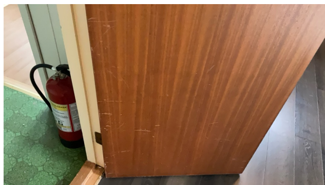
Skader/sår i dørblad.
