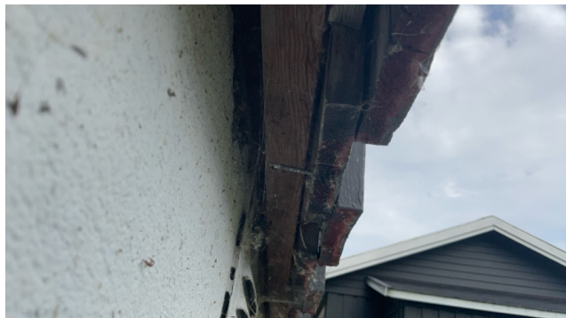
Eksempel på dårlig lufting bak kledning.
