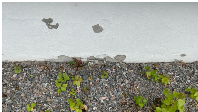
Eksempel på løs puss på grunnmur.
