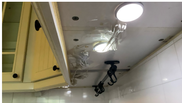
Ufagmessig utførelse av spotter under overskap.
