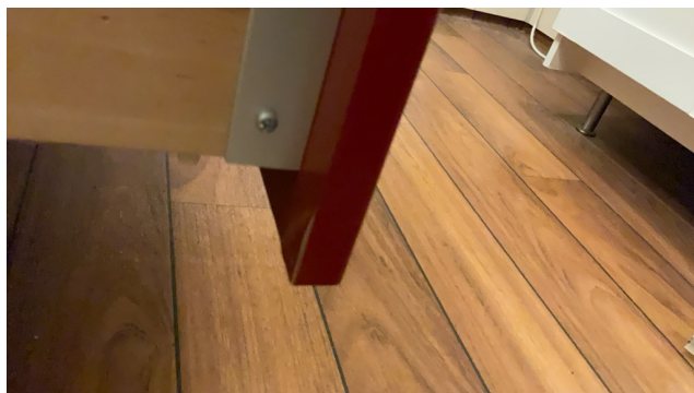
Svellskader i innredning.
