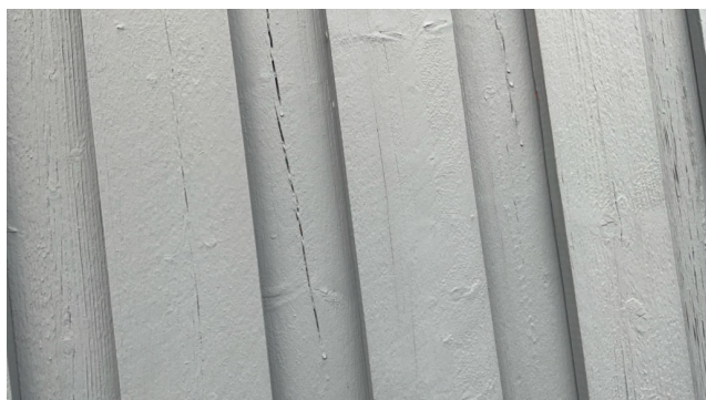
Eksempel på sprekker i kledning.
