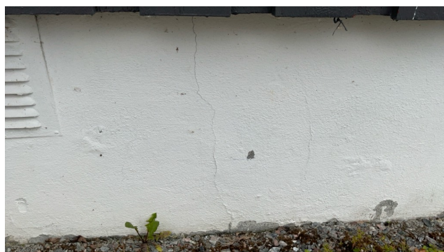
Eksempel på sprekkdannelser i grunnmur.
