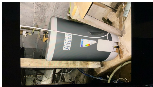
Varmtvannsbereider montert i krypkjeller.
