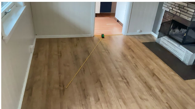
Meterstokk viser hvor avvik er registrert.
