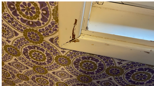
Skade på listverk.
