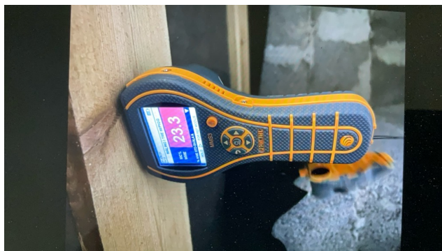
Eksempel på fukt i treverk.
