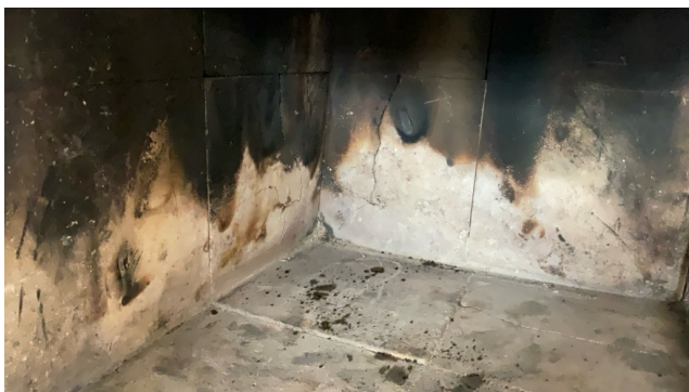
Sprekker i ildsted.
