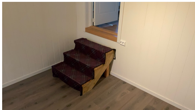
Innvendig trapp mangler rekkverk.
