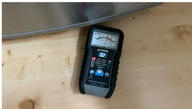
Fuktindikator gir utslag på fukt rundt utsatte hvitevarer.
