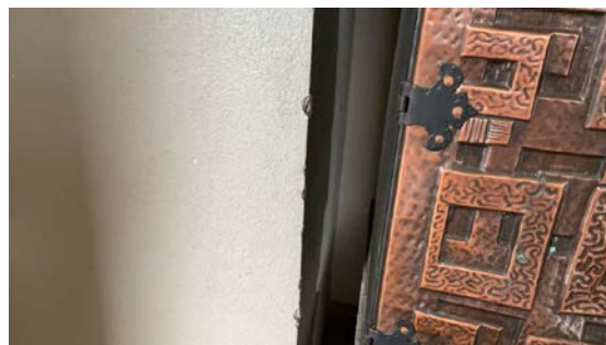
Hjørne på pipe har pussavskaling.
