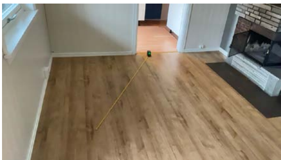
Meterstokk viser hvor avvik er registrert.
