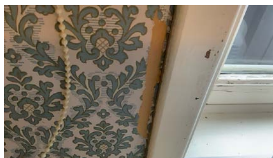
Tapet har skade.
