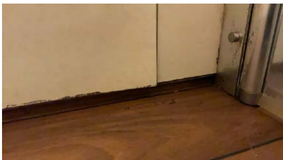
Plate er løs i dusjsone.
