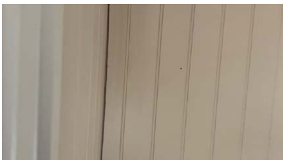
Eksempel på ufagmessig utførelse av veggplater.
