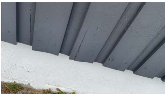
Eksempel på sprekker i kledning.
