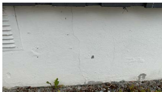
Eksempel på sprekk i grunnmur.
