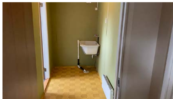
Vaskerom trolig fra byggeår.
