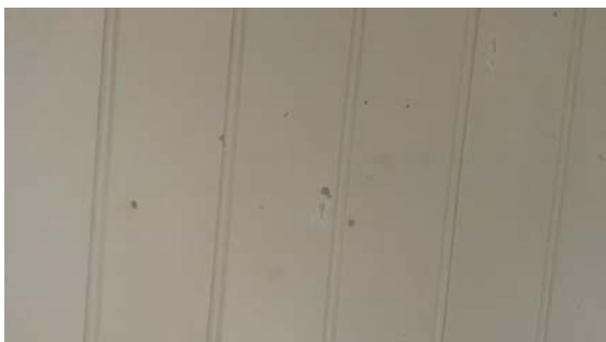
Sår/skader i veggplater.
