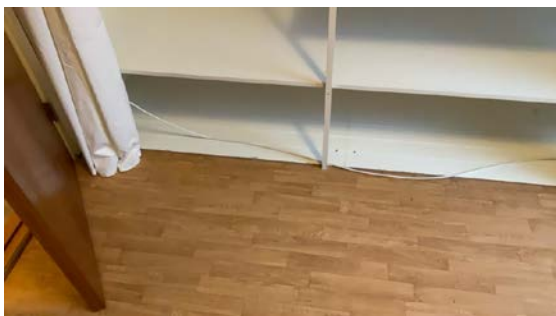
Kabel ikke festet.
