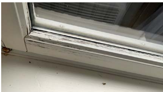
Vinduer fra byggeår er slitte.
