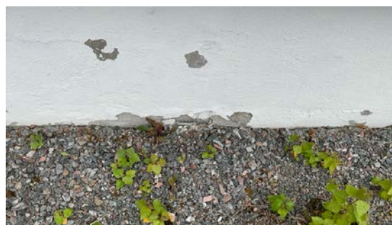
Eksempel på at puss har løsnet.
