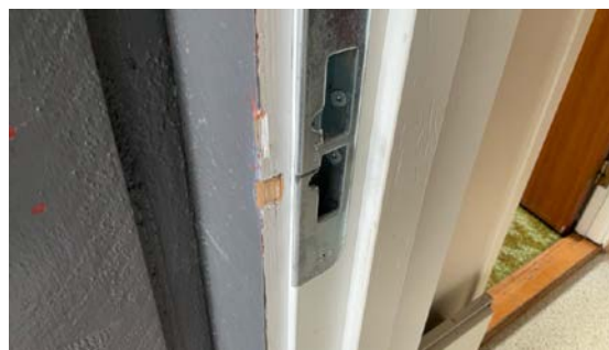
Skade i omramming.
