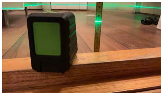
Det er målt 10cm på gulv ved terskel.
