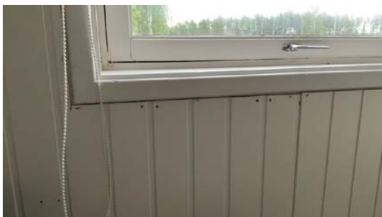
Ufagmessig utførelse på plater/listeverk
