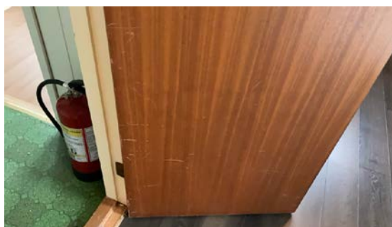
Skader/sår i dørblad.
