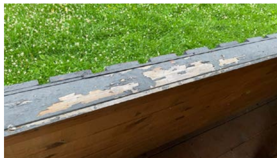
Eksempel på avflassing av maling.
