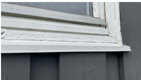
Eksempel på sprekker i trevirke.
