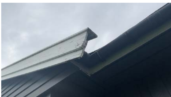
Eksempel på råteskader i vinds kier/isbord.
