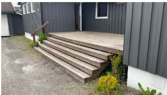
Trapp mangler rekkverk.
