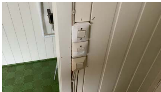
Skadede brytere er tapet over.
