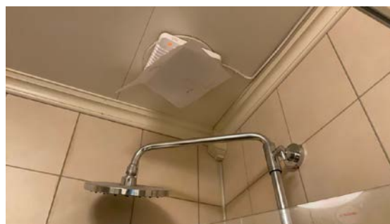
Ark henger på avtrekksventil. Bra avtrekk.
