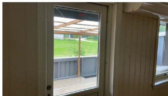
Sprukket glass i terrassedør.
