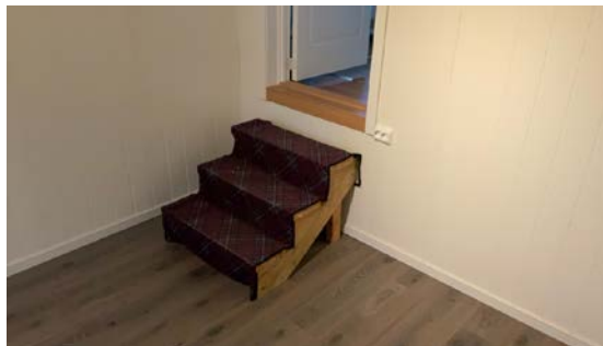
Innvendig trapp mangler rekkverk.
