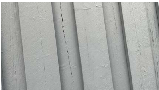
Eksempel på sprekker i kledning.
