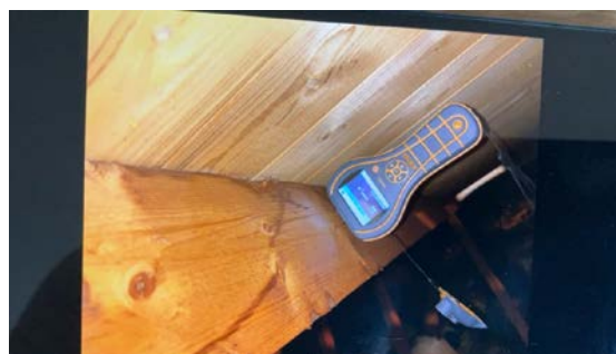
Fuktmåling i fuktskjolder uten unormale resultater.
