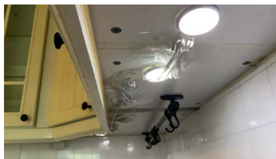
Ufagmessig utførelse av spotter under overskap.
