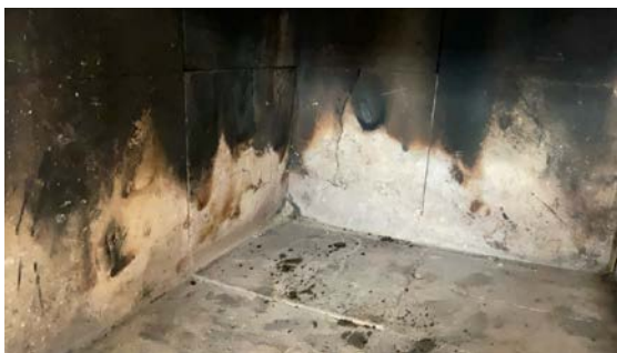
Sprekker i ildsted.
