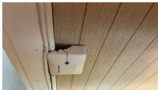
Lysbryter er defekt.
