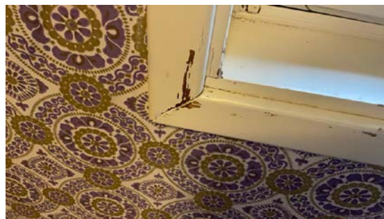
Skade på listverk.
