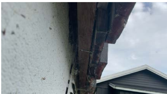
Eksempel på dårlig lufting bak kledning.
