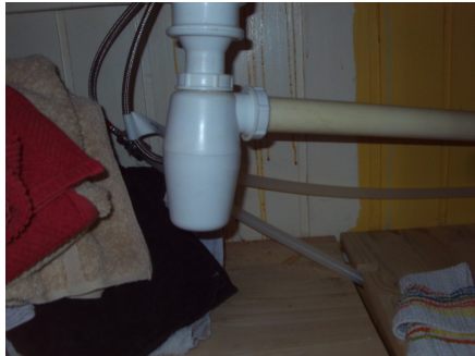
Noe av røropplegget på badet
