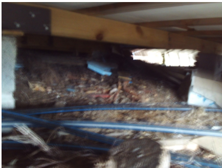
Lav høyde enkelte steder.
