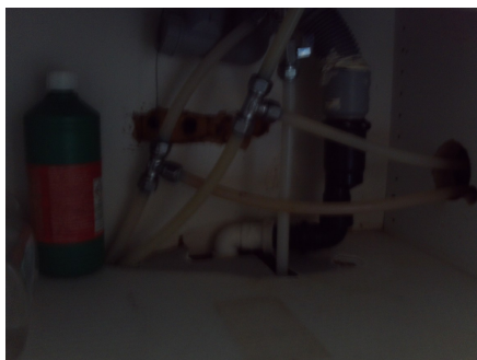
Røropplegg i kjøkkenbenken.
