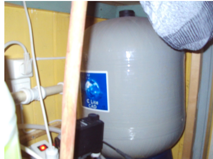
Trykktank er plassert på badet.
