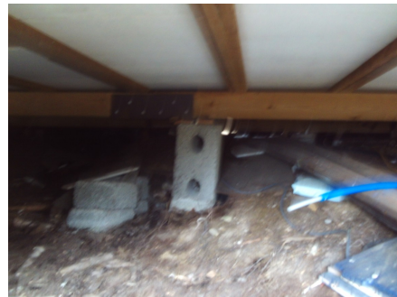
Noen skjeve pilarer.
