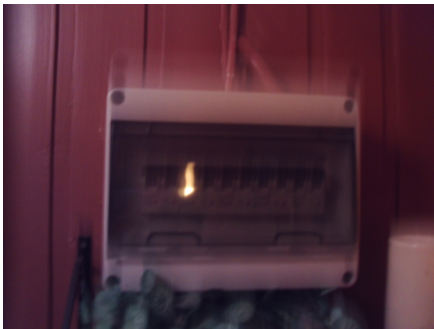
Sikringsskapet er plassert på toalettrom.
