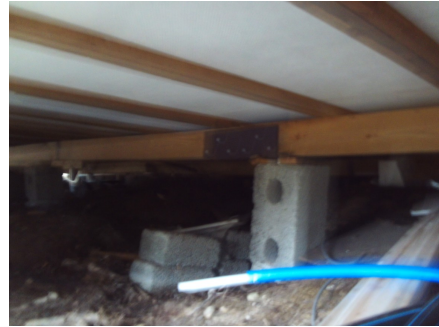
Noe sig og skjevheter på enkelte pilarer.
