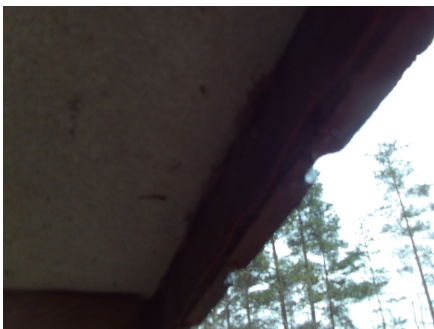
Ingen/lite tilgang på luft bak kledningen.
