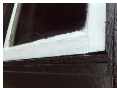
Vinduer har fått en del slitasje på utvendig karm og ramme.
