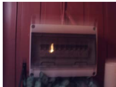
Sikringsskapet er plassert på toalettrom.
