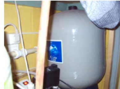
Trykktank er plassert på badet.
