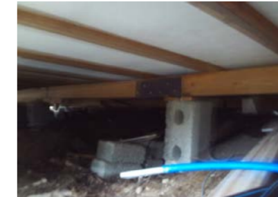
Noe sig og skjevheter på enkelte pilarer.
