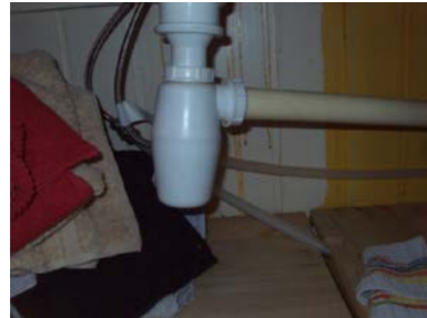
Noe av røropplegget på badet
