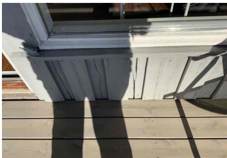
Kledning med tørkesprekker mm.
