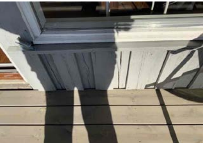
Kledning med tørkesprekker mm.
