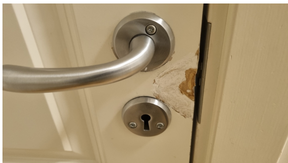
Skade på dørblad.
