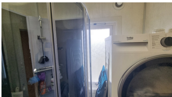
Det er vindu i våtsonen ved dusjkabinett.
