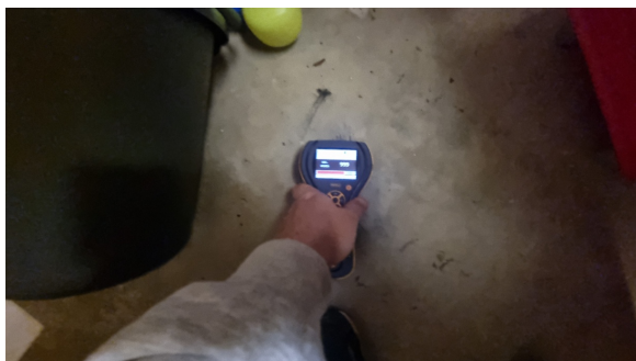
Det ble registrert forhøyde fuktverdier.
