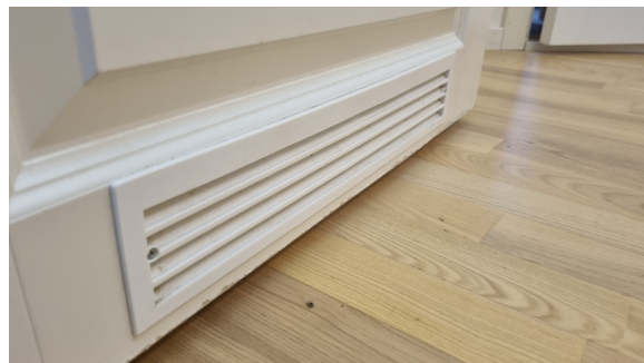
Tilluft via luftespalte i dørblad.
