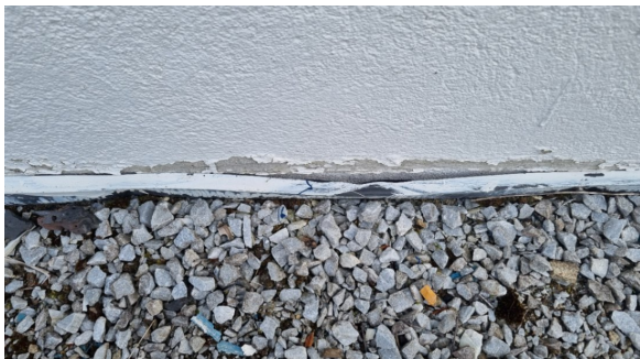
Klemlist er løsnet og den er heller ikke pusset inn eller på annen måte forseglet.
