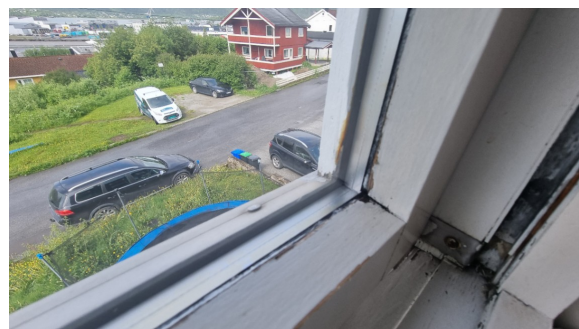
Vindu har værslitasje.
