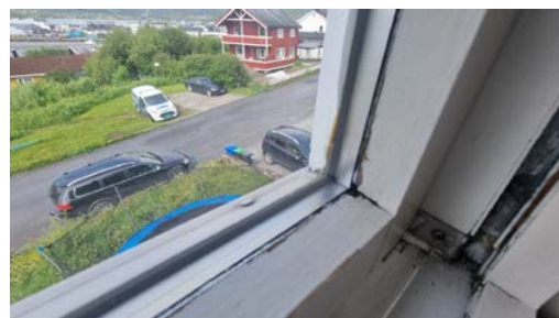
Vindu har værslitasje.
