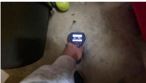
Det ble registrert forhøyde fuktverdier.
