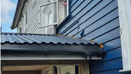
Det mangler nedløp og tak-vegg beslag.
