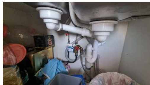
Det er montert Waterguard.
