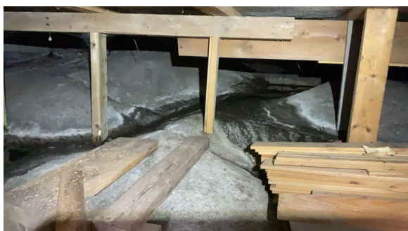
Fritt vann som har fulgt fjellet inn i krypkjelleren.
