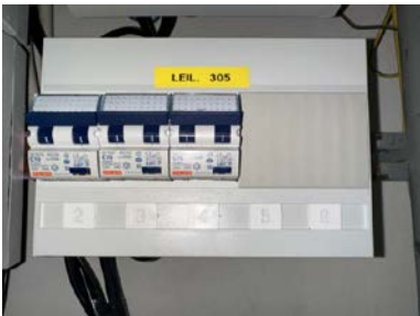
Sikringsskap med automatsikringer.
