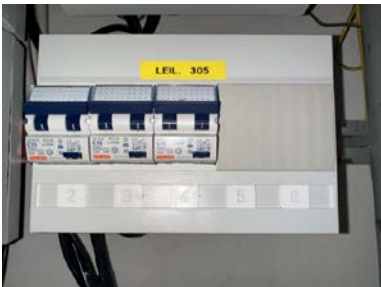
Sikringsskap med automatsikringer.
