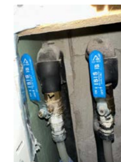
Stoppekranner plassert på bad
