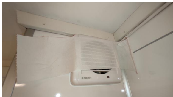
Test av avtrekket.
