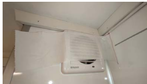
Test av avtrekket.
