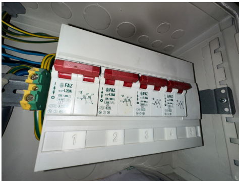
Sikringskapp med automatsikringer.
