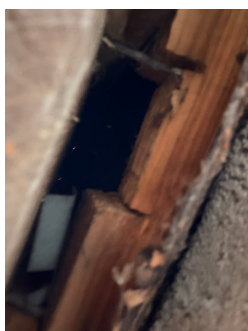
Mangler musesperre enkelte steder
