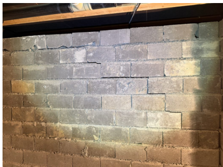
Sprekker etter jordtrykk
