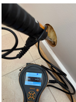
Ingen utslag på Protimeter MMS2 ved bruk av pigger.
