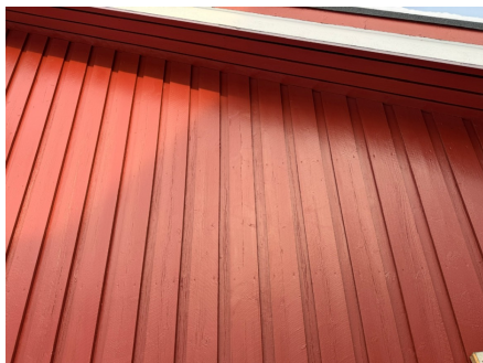
Sprukket kledning mot sør
