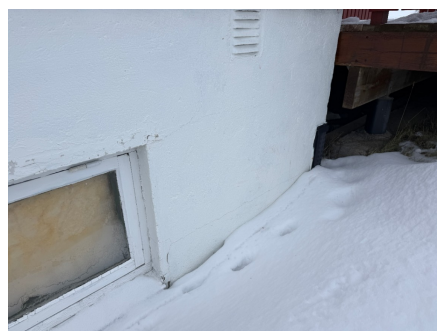
Noen sprekker utvendig på mur.
