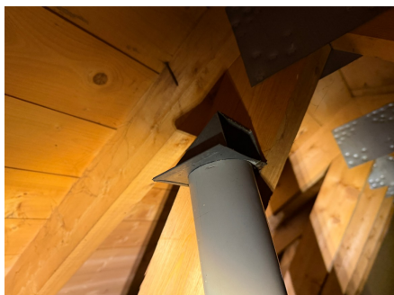
Lufting fra kjøkken er avsluttet på kaldloft. Uisolert.
