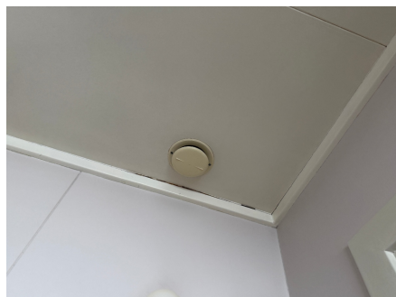
Naturlig ventilasjon i tak
