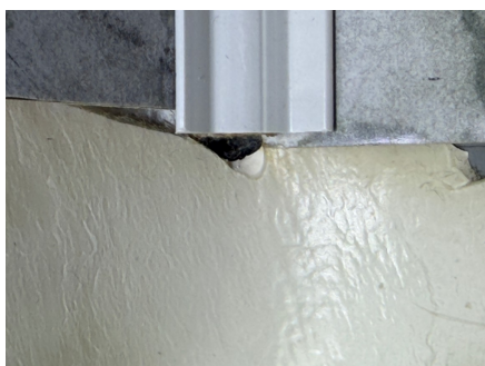
Belegg er ikke lagt bak baderomsplater
