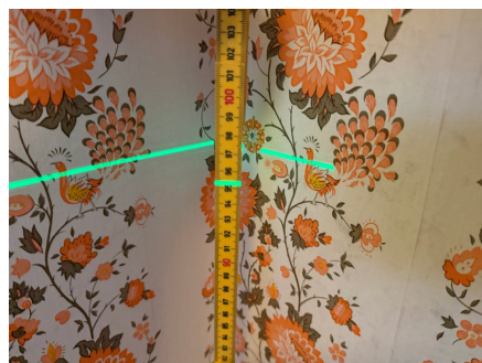
Laveste punkt ved vegg til trapperom 95,5 cm, motfall til sluk på ca. 6 mm.
