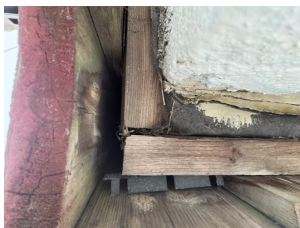
Mangler musesperre enkelte steder
