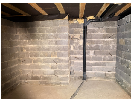
Sprekker etter jordtrykk
