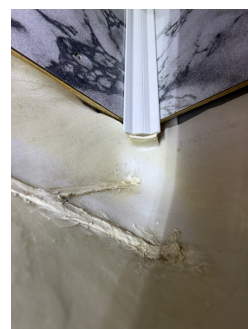
Belegg er ikke lagt bak baderomsplater
