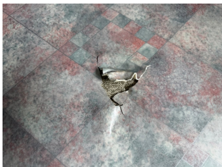
Skade på belegget på soverom.
