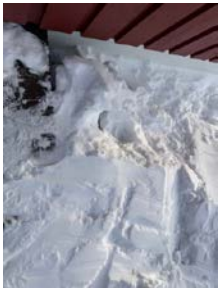
Trappen var snødekt ved befaring.
