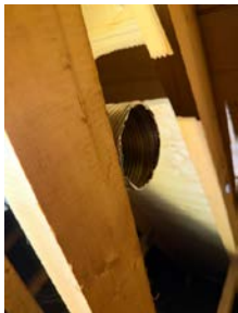
Lufting fra trapperom er avsluttet på kaldloft. Uisolert.
