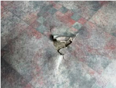
Skade på belegget på soverom.
