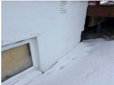
Noen sprekker utvendig på mur.
