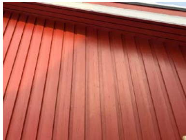
Sprukket kledning mot sør
