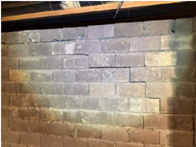
Sprekker etter jordtrykk
