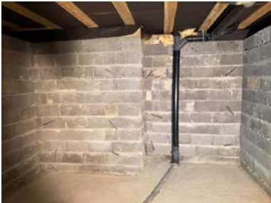
Sprekker etter jordtrykk
