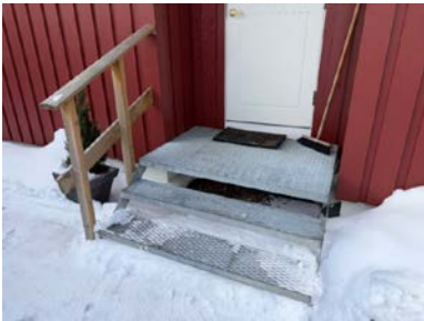
Trappen er noe skjev
