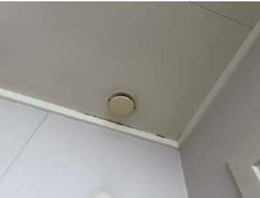
Naturlig ventilasjon i tak
