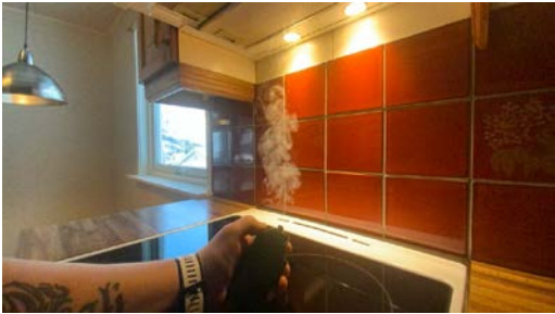
Funksjonstest av ventilator. Ok.
