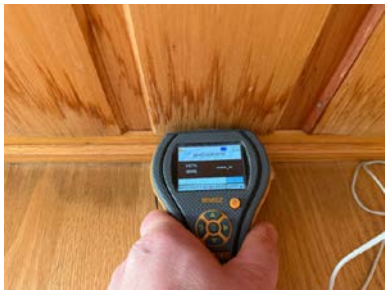
Fuktmerker i panel under stuevinduer, tørt ved befarings.
