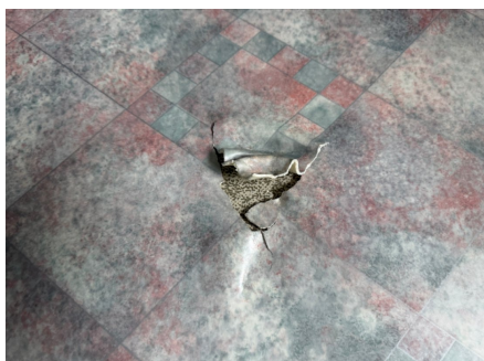
Skade på belegg på soverom.
