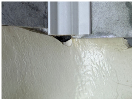
Belegg er ikke lagt bak baderomsplater
