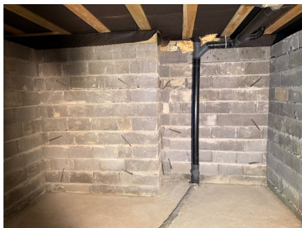
Sprekker etter jordtrykk
