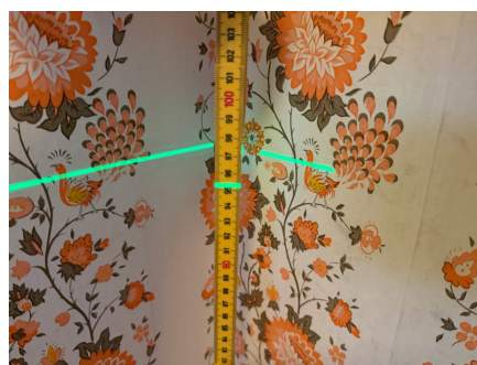
Laveste punkt ved vegg til trapperom 95,5 cm, motfall til sluk på ca. 6 mm.
