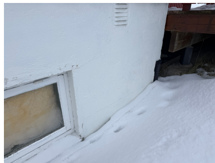
Noen sprekker utvendig på mur.
