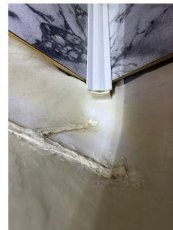
Belegg er ikke lagt bak baderomsplater
