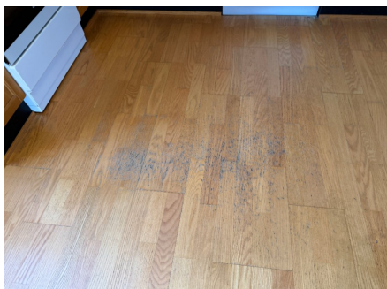
Slitasje parkett kjøkken.
