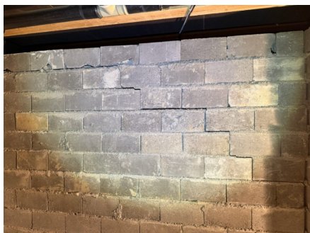
Sprekker etter jordtrykk
