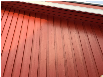
Sprukket kledning mot sør
