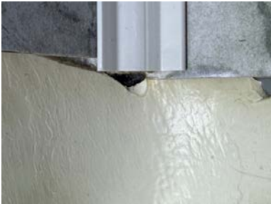
Belegg er ikke lagt bak baderomsplater
