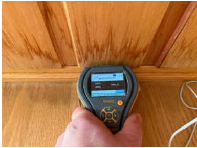
Fuktmerker i panel under stuevinduer, tørt ved befarig.
