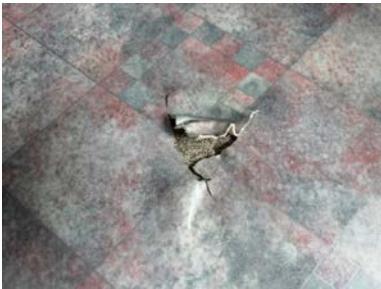
Skade på belegg på soverom.
