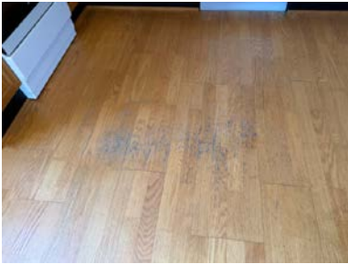
Slitasje parkett kjøkken.
