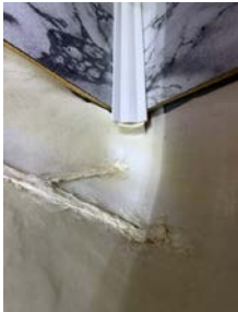
Belegg er ikke lagt bak baderomsplater
