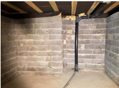
Sprekker etter jordtrykk
