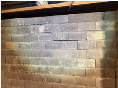
Sprekker etter jordtrykk
