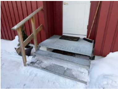
Trappen er noe skjev
