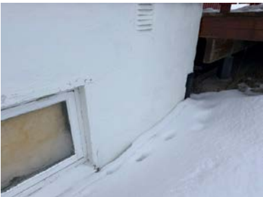
Noen sprekker utvendig på mur.
