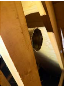
Lufting fra trapperom er avsluttet på kaldloft. Uisolert.
