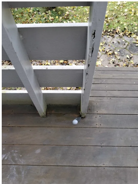
Det registreres råteskader i rekkverk.
