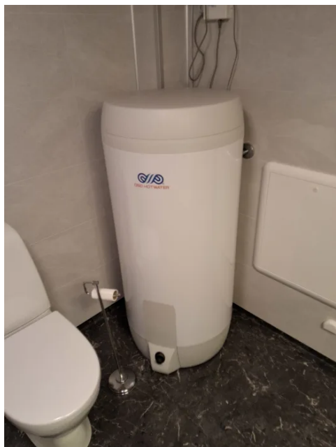
Varmtvannsbereder er plassert på bad i kjeller.
