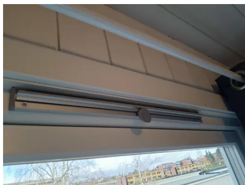
Naturlig ventilering via spalteventiler i vinduer.
