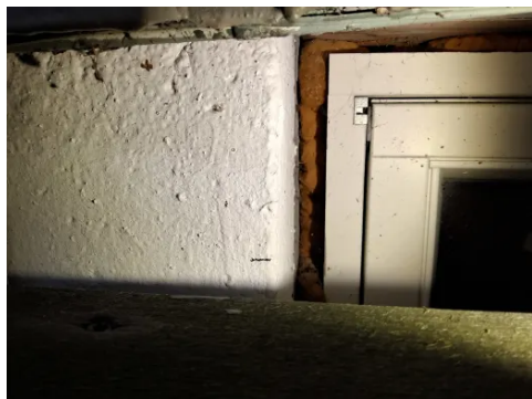
Det er kun tettet med byggsaum mellom karm og kjellermur.
