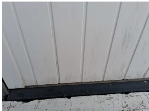
Balkongdør er fuktpåvirket.
