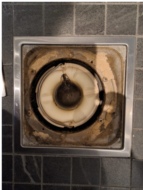
Det ble ikke registrert avvik i overgang sluk/membran.
