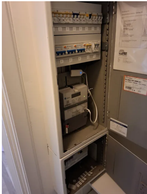
Sikringsskap er plassert i gang.
