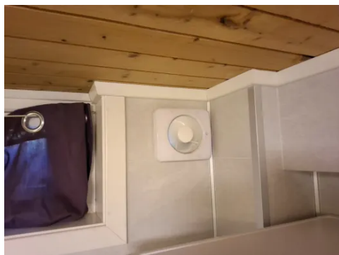
Avtrekksviften er funksjonstestet.
