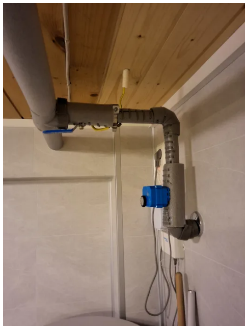
Hovedstoppekran er plassert i kjellerbad.
