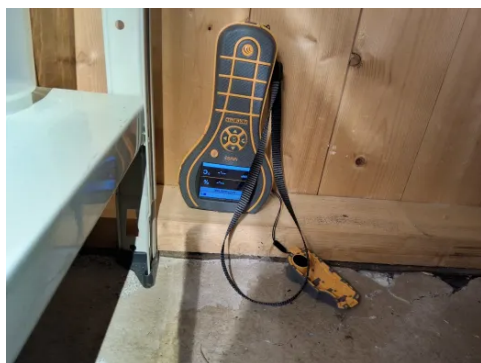
Bilde fra fuktmåling i bunnsvill i vegg tilstøtende fuktsone.
