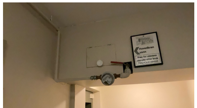
Eier opplytter at hovedstoppekran for bygget er i kjeller ved inngang heis.
