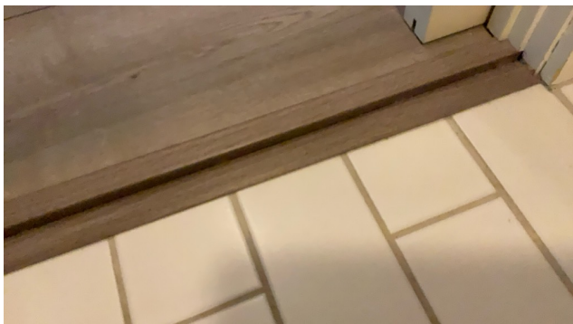
Høydeforskjell sluk og gulv ved dørterskel uten oppkant er 12 mm
