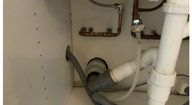
Vannrør asv kobber.
