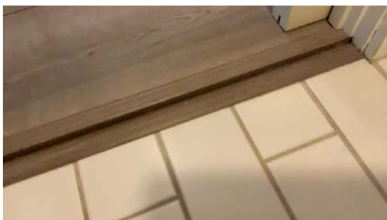
Høydeforskjell sluk og gulv ved dørterskel uten oppkant er 12 mm ETASJE > BAD
