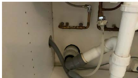
Vannrør av kobber.
