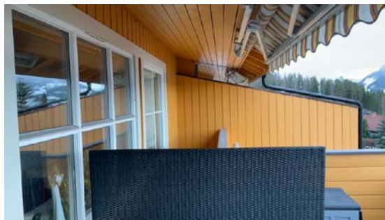
På terrasser er det åpninger mot tilstøtende boenheter fra yttervegg og utover terrasser også under takoverbygg
