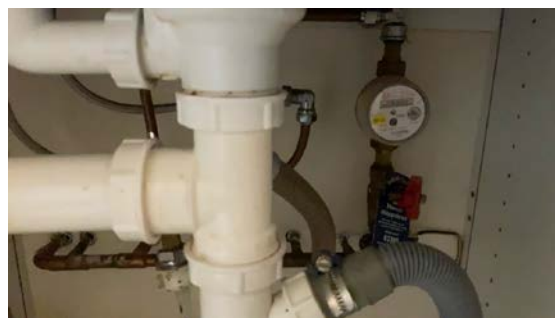
Vannmåler for boligen er i kjøkkenbenk
