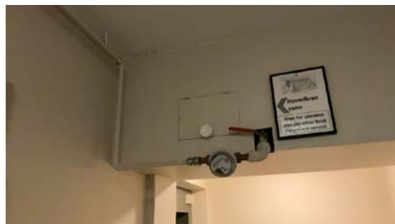
Eier opplytter at hovedstoppekran for bygget er i kjeller ved inngang heis.
