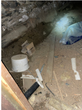
Synlig fuktighet i nedkant av gammel mur.
