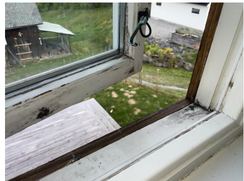
Vindu med høy fuktighet i karm.
