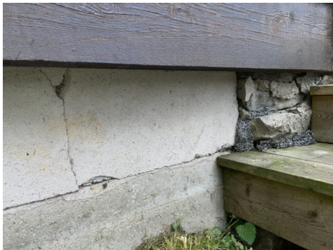
sprekker i ringmur
