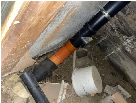
Synlig muggsopp på løssøre.
