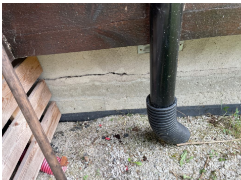
Horisontal sprekk i ringmur.
