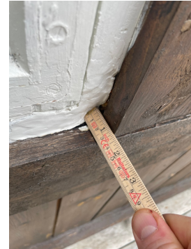
Gammel skade utbedret med elastisk fugemasse. Mangler vannbrett i overgang.
