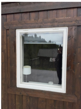
Vinduer mangler vannbrett og har ufaglig løsning.
