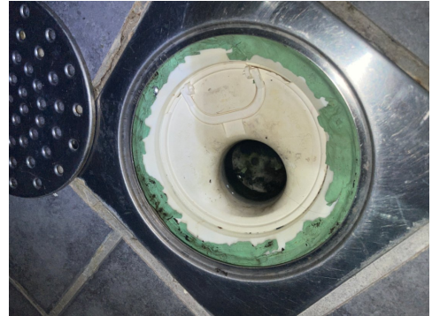
Sluk i gulv. Ufaglig løsning på membran.
