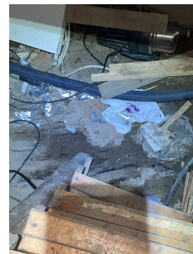
Synlig fuktinnsig og muggsopp på løssøre.
