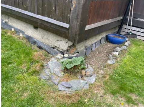
Skade i ringmur på hjørne
