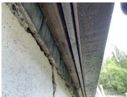
Gammel vegg synlig ved murkone og hvor det er liten effekt av utført etterisolering.
