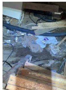
Synlig fuktinnsig og muggsopp på løsøre.
