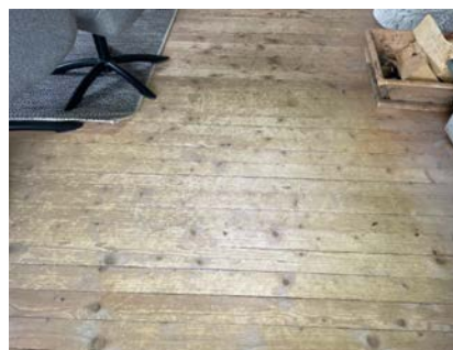
Gulv med mye riper utover normal slitasje.
