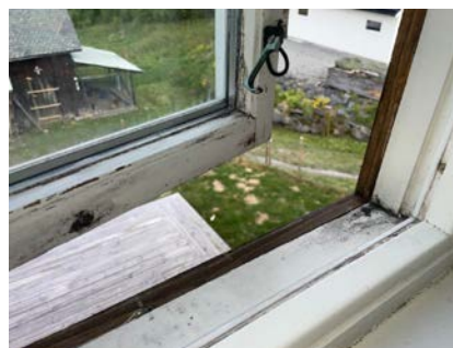
Vindu med høy fuktighet i karm.
