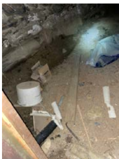
Synlig fuktighet i nedkant av gammel mur.
