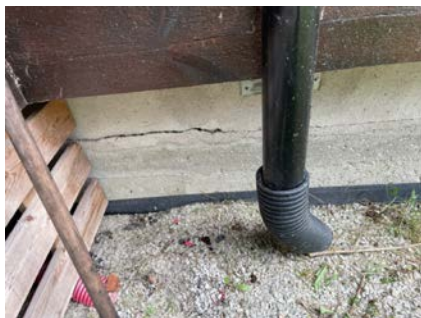
Horizontal sprekk i ringmur.
