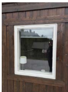
Vinduer mangler vannbrett og har ufaglig løsning.
