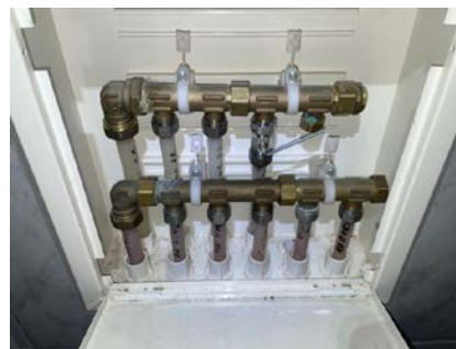
Rør merking begynner å bli borte/vanskelig å tyde
