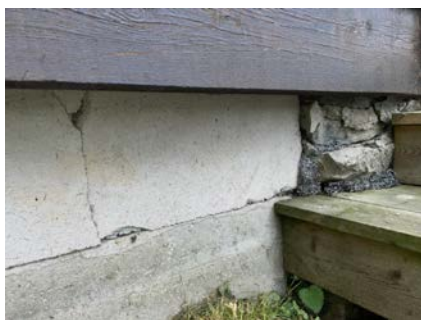
sprekker i ringmur
