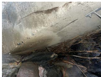
Manglende bortledning av takvann
