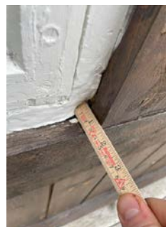
Gammel skade utbedret med elastisk fugemasse. Mangler vannbrett i overgang.
