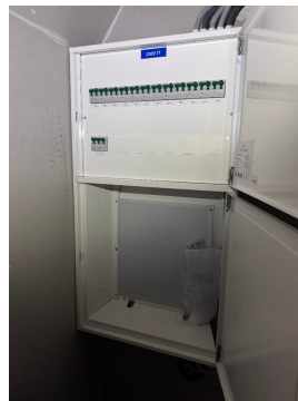
Fordelerskapet til det elektriske anlegget er montert i den utvendige boden/tekniske rommet.
