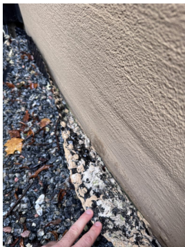
Manglende avslutning av knotteplasten.
