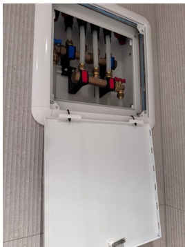
Fordeleskapet til rør-i-rør-systemet er tilgjengelig på badet.
