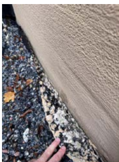
Manglende avslutning av knotteplasten.
