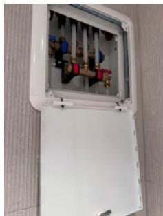
Fordelerskapet til rør-i-rør-systemet er tilgjengelig på badet.
