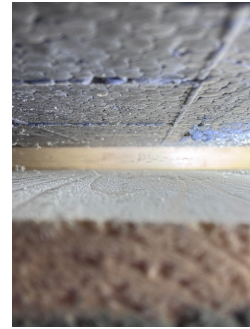
Dette bildet er tatt fra undersiden av panelen og viser den horisontale lekten som stenger for luft og drenering bak ytterkledningen.
