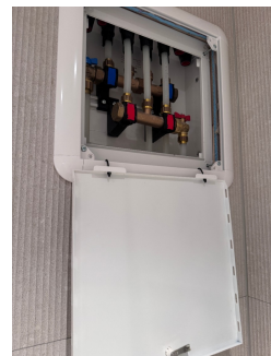
Fordelerskapet til rør-i-rør-systemet er tilgjengelig på badet.
