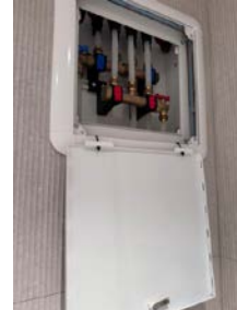
Fordelerskapet til rør-i-rør-systemet er tilgjengelig på badet.
