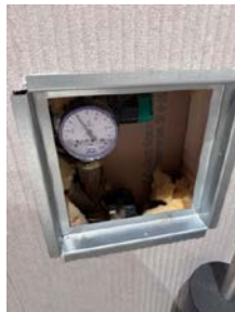
Vannmåler er tilgjengelig via en inspeksjonsluke på badet.
