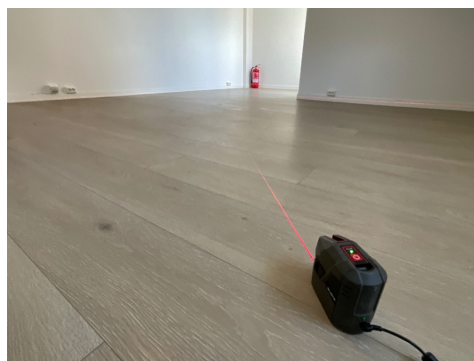
Nivellering stue/kjøkken, avvik 15-30 mm
