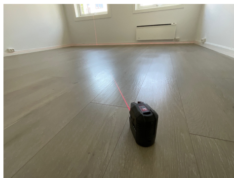
Nivellering soverom, avvik ca. 10-20 mm
