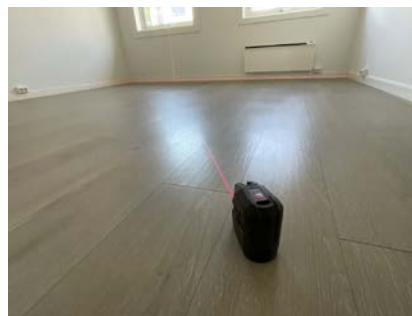
Nivellering soverom, avvik ca. 10-20 mm
