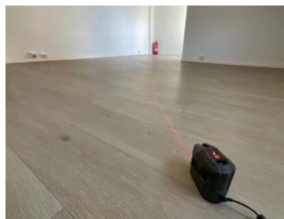
Nivellering stue/kjøkken, avvik 15-30 mm
