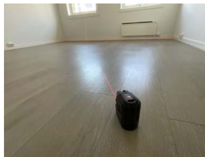
Nivellering soverom, avvik ca. 10-20 mm
