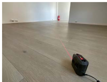
Nivellering stue/kjøkken, avvik 15-30 mm
