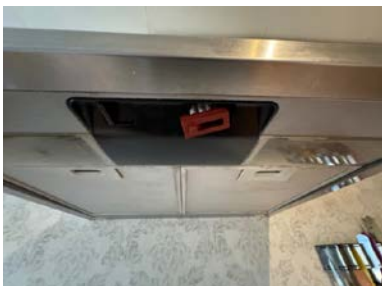
Løs bryter på ventilatoren
