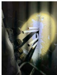
Eksempel på rør som er tatt ut av bruk.
