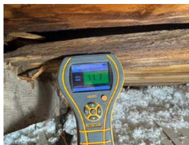
Fuktmåling i råteskadet taktro.
