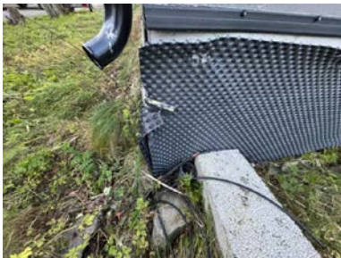
Takrennenedløp er avsluttet med utkast ved grunnmuren.
