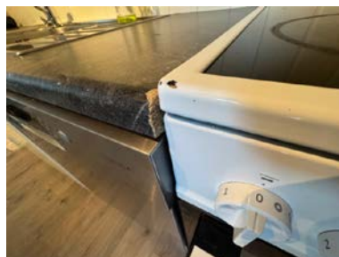
Det er ikke kantlist på benkeplaten.
