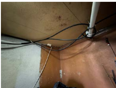
Eksempel på vannrør som ikke er tilstrekkelig klamret fast
