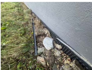
Tettesjikt som er montert feil vei.
