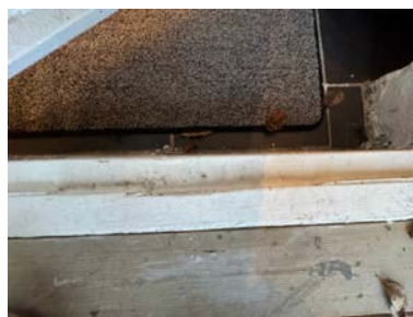
Skadet pakning på døren til underetasjen.
