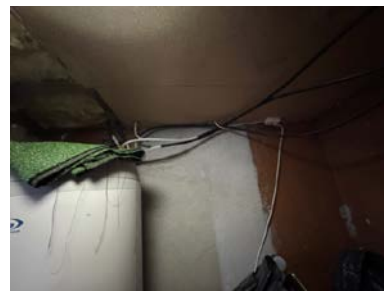
Eksempel på vannrør som ikke er tilstrekkelig klamret fast.
