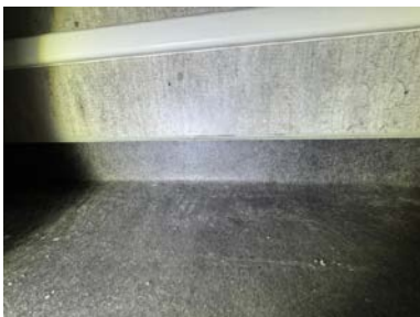
Eksempel på svikt i fugemassen.
