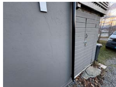
Eksempel på riss i grunnmuren.
