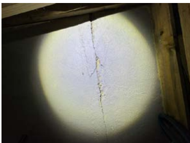
Eksempel på sprekk i grunnmuren.
