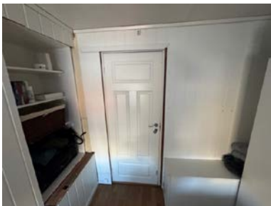
Fagmessig utførelse av listing.
