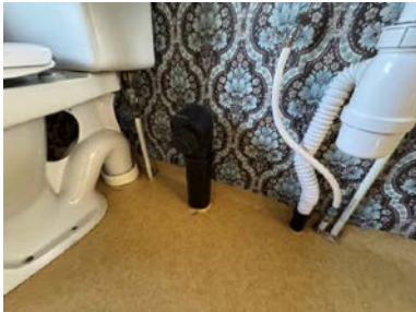
vakumventil på badet i 2. etasjen.
