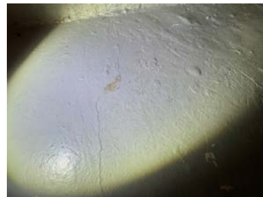
Skader i malingen.
