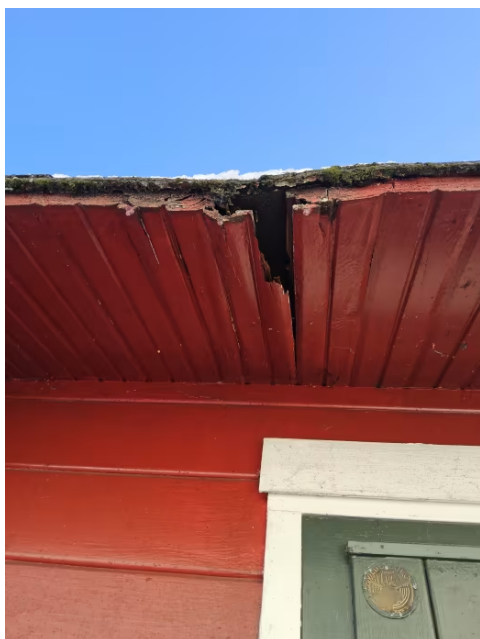
Det registreres råteskader i takkonstruksjonen.
