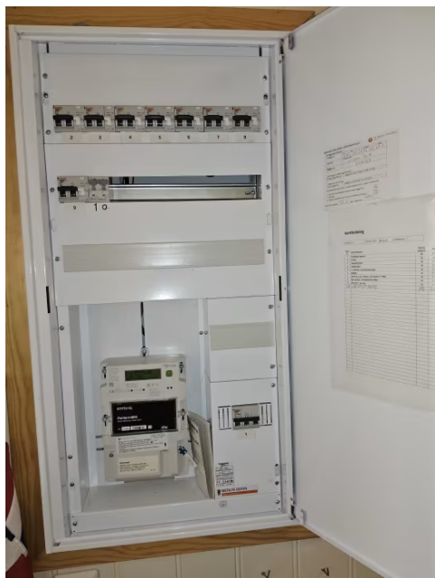
Sikringsskap plassert i bod/teknisk rom.
