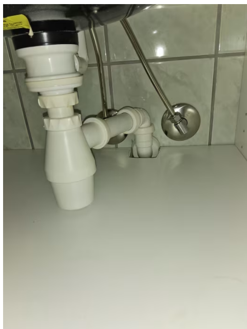
Synlige avløpsrør av plast.
