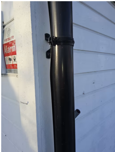
Enkelte nedløpsrør viser symptomer på frostspreng.
