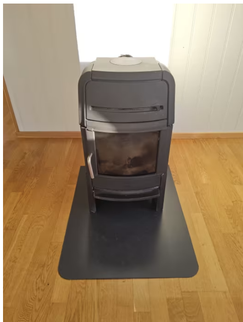
Vedovn med glassdør i stue.
