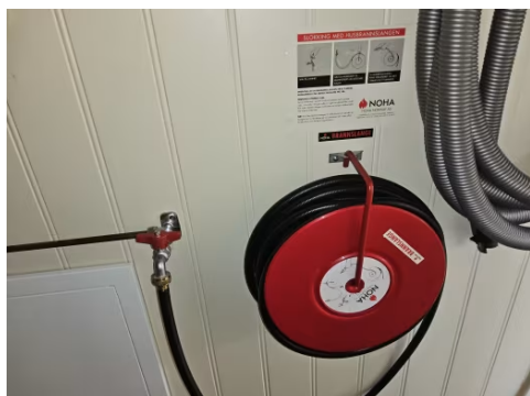
Husbrannslange er montert i bod/teknisk rom.
