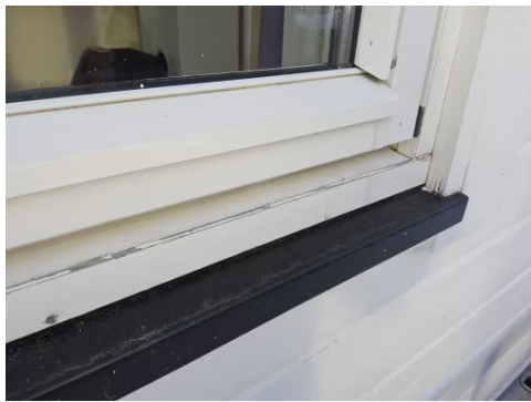
Det registreres enkelte malingslitte vinduskarmer.
