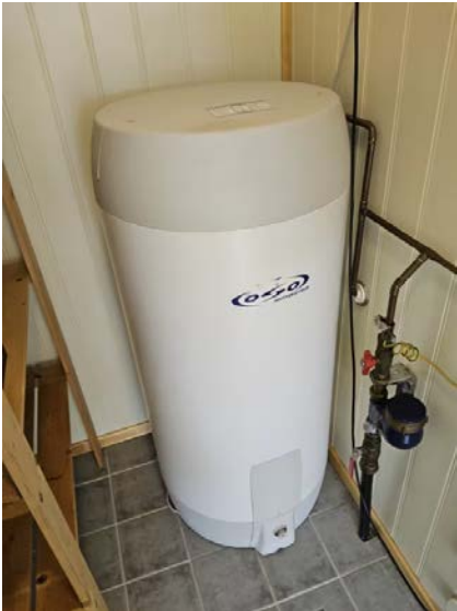
Varmtvannsbereder er plassert i bod/teknisk rom.
