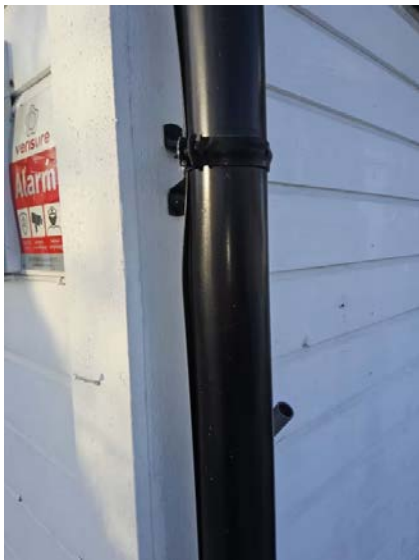
Enkelte nedløpsrør viser symptomer på frostspreng.
