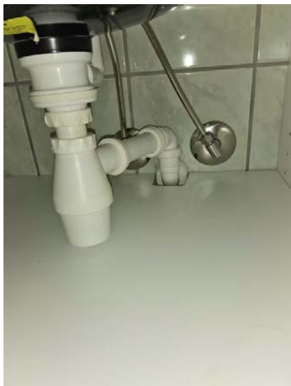
Synlige avløpsrør av plast.
