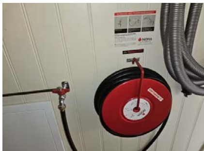
Husbrannslange er montert i bod/teknisk rom.
