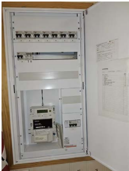
Sikringsskap plassert i bod/teknisk rom.
