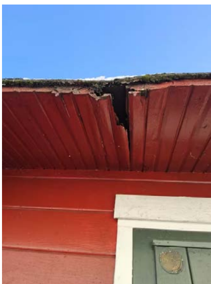
Det registreres råteskader i takkonstruksjonen.
