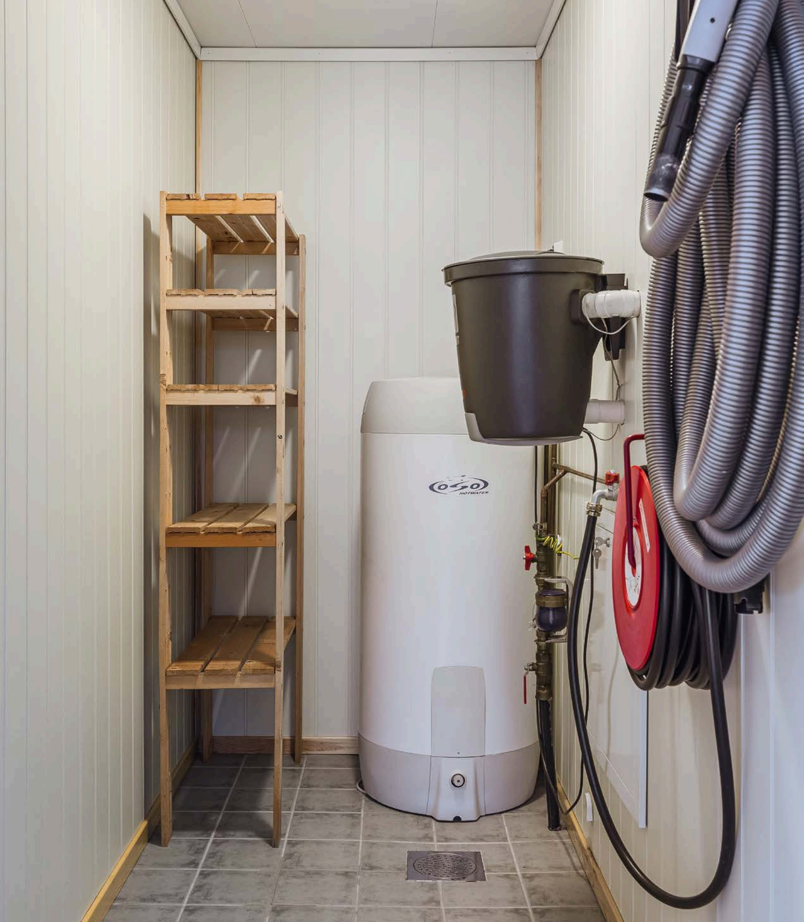
Praktisk innvendig bod/teknisk rom med lagringsmuligheter. Rommet er utstyrt med nytt fordelerskap i mars 2025, varmtvannsbereider på 198 liter, sentralstøvsuger, husbrannslange og sikringskap med automatsikringer.
