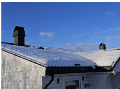
Taktekking var snødekt befaringsdagen.
