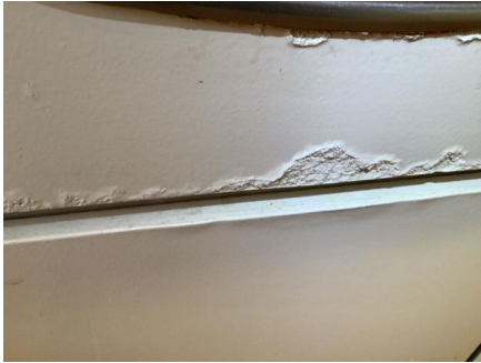
Eksempler på svellskader på innredning.
