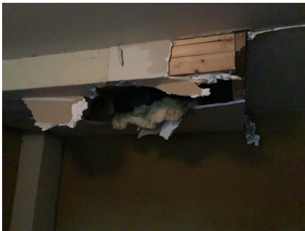
Gipsplater på nedkasset himling er enkelt revet.
