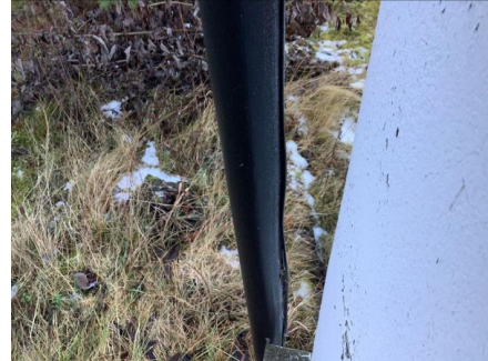
Eksempel på frostsprengt nedløpsrør.
