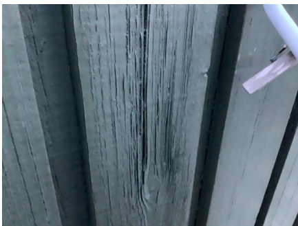
Eksempel på værslitt og oppsprukket bordkledning.
