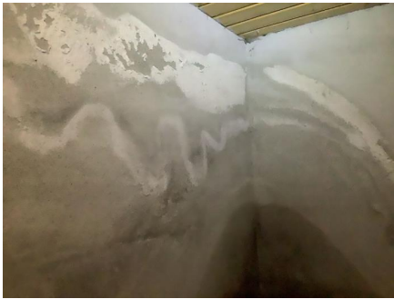
Saltutslag på delevegg.
