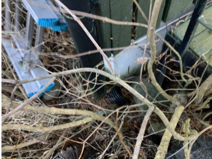
Mangelfull bortledning av takvann.
