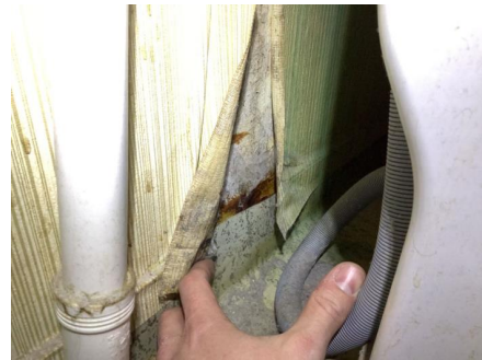
Eksempel på løsnet tapet.
