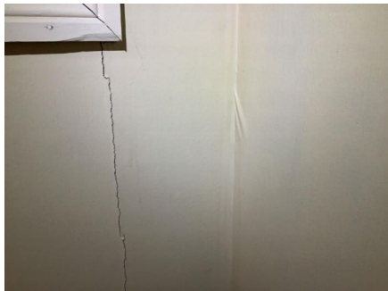
Revnet tapet, og løs tapet som bølgjer seg i hjørne.
