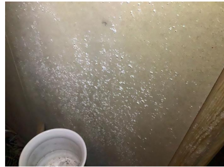
Tegn til soppdannelse på veggplate på delevegg.
