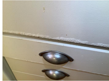
Eksempler på svellskader på innredning.
