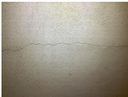
Eksempel på innvendig horisontalriss.
