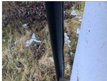
Eksempel på frostsprengt nedløpsrør.
