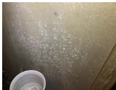
Tegn til soppdannelse på veggplate på delevegg.
