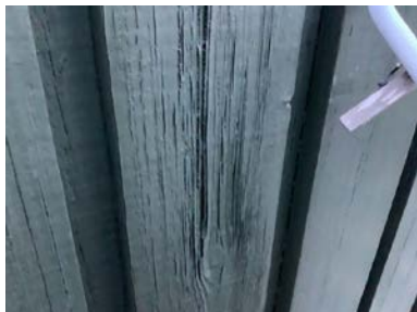
Eksempel på værslitt og oppsprukket bordkledning.
