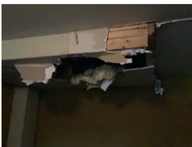
Gipsplater på nedkasset himling er enkelt revet.
