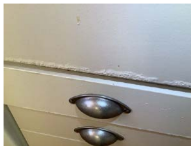
Eksempler på svellskader på innredning.
