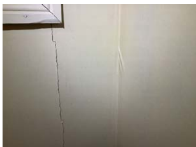
Revnet tapet, og løs tapet som bølger seg i hjørne.
