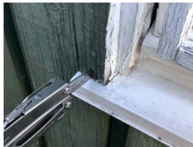
Omrømming er ført helt ned til vannbrett og dette har ført til råteskader.
