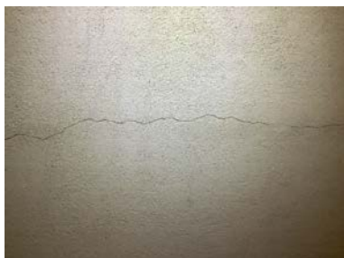
Eksempel på innvendig horisontalriss.
