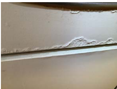
Eksempler på svellskader på innredning.
