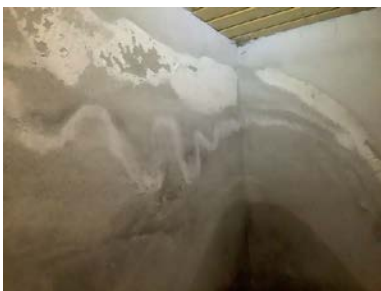
Saltutslag på delevegg.
