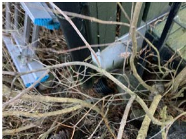
Mangelfull bortledning av takvann.
