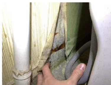
Eksempel på løsnet tapet.
