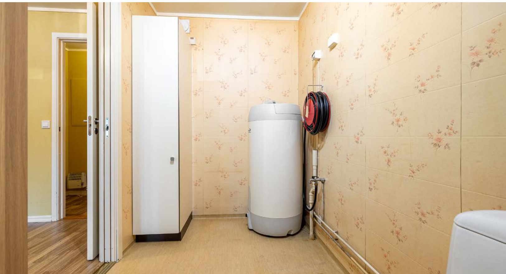
På badet finner du også varmtvannsberederen og opplegg for vaskemaskin.
