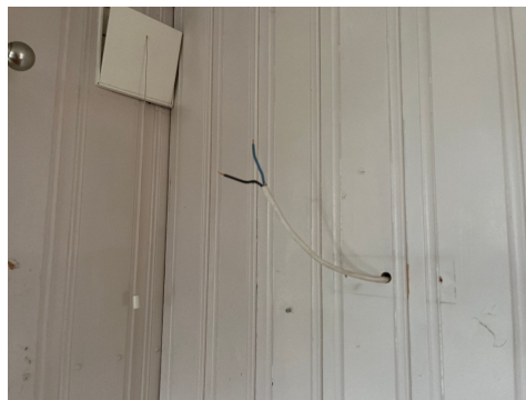
Løs ledning ut av vegg.
