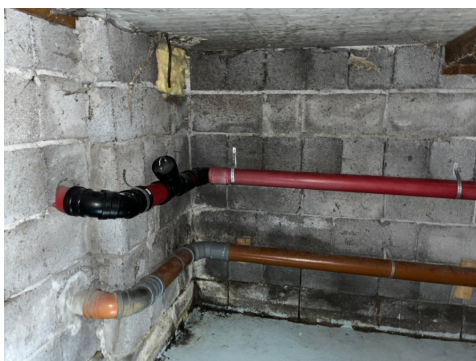
Saltutslag på vegger
