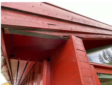
Råteskade i vindski
