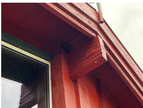
Råteskade i limtrebjelker
