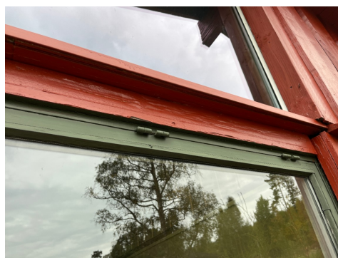
Råteskade i omramming på vindu
