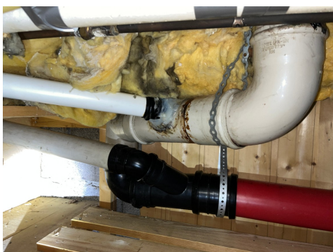
Ufagmessig tilkobling på avløpsrør.
