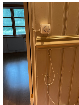
Tynne ledninger til bryter/lamper.
