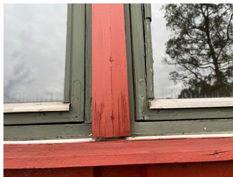
Råteskade i vindu, punktert glass.
