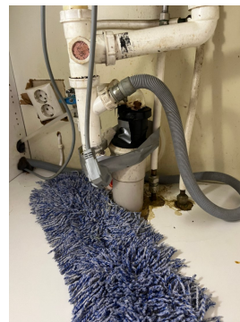
Lekkasje fra avløpsrør kjøkken
