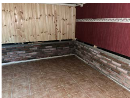
Råteskadet panel fjernet.
