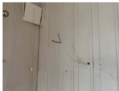
Løs ledning ut av vegg.
