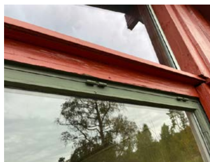
Råteskade i omramming på vindu
