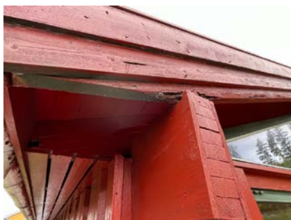
Råteskade i vindski
