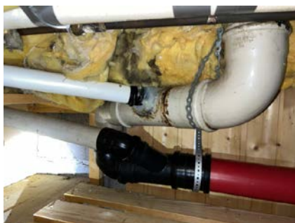
Ufagmessig tilkobling på avløpsrør.
