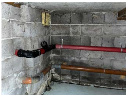
Saltutslag på vegger
