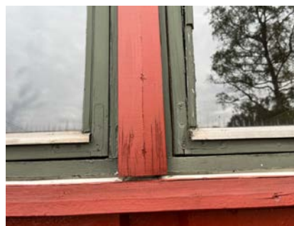
Råteskade i vindu, punktert glass.
