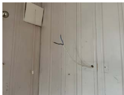
Løs ledning ut av vegg.
