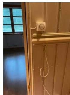
Tynne ledninger til bryter/lamper.
