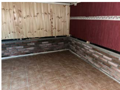
Råteskadet panel fjernet.
