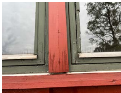
Råteskade i vindu, punktert glass.
