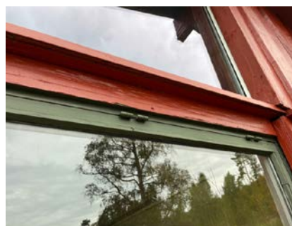
Råteskade i omramming på vindu
