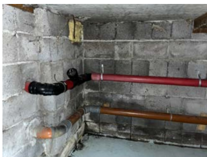
Saltutslag på vegger
