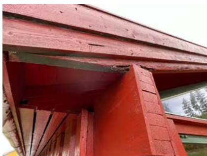
Råteskade i vindski
