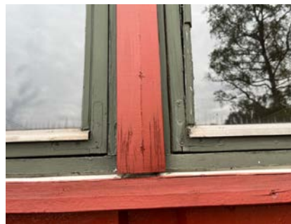
Råteskade i vindu, punktert glass.
