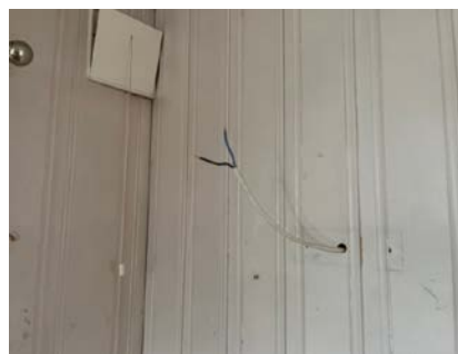
Løse ledning ut av vegg.
