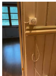
Tynne ledninger til bryter/lamper.
