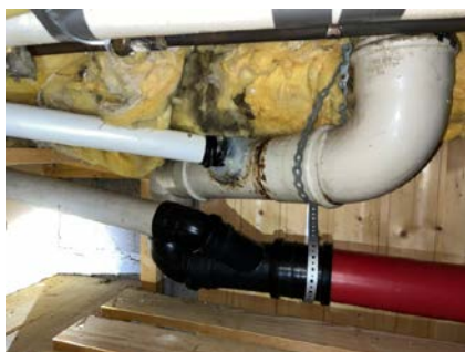
Ufagmessig tilkobling på avløpsrør.
