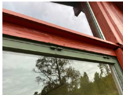
Råteskade i omramming på vindu
