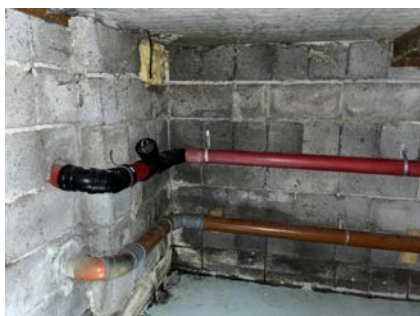
Saltutslag på vegger
