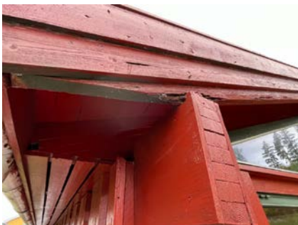
Råteskade i vindski
