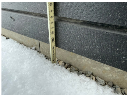
Kledning er avsluttet nærme terreng.
