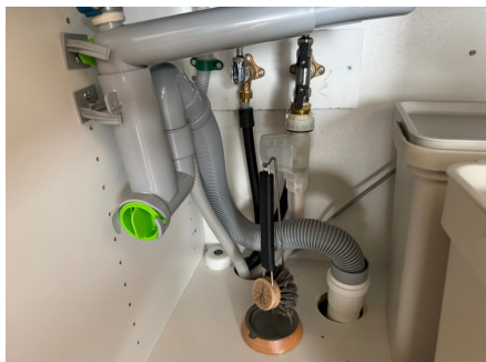
Synlige avløpsør i plast.
