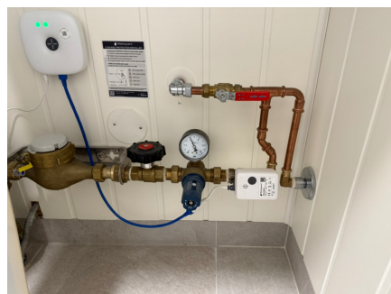
Hovedstoppekran er lokalisert i teknisk rom.
