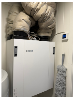
Ventilasjonsaggregat er plassert i teknisk rom.
