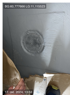
Bilde fra uavhengig kontroll - overgang membran/sluk
