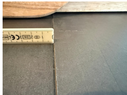
Trapping på skjøt i benkeplate.
