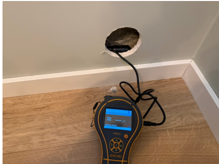
Bilde fra fuktmåling i veggkonstruksjon tilstøtende våtsone.
