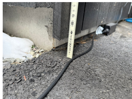
Kledning er avsluttet nærme terreng.
