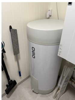
Varmtvannstank er plassert i teknisk rom.
