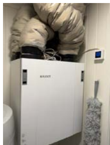
Ventilasjonsaggregat er plassert i teknisk rom.
