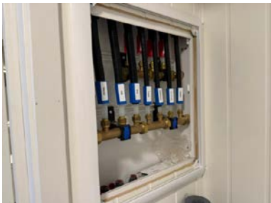
Fordelerskap er lokalisert i teknisk rom.
