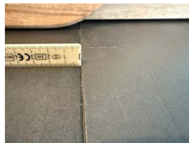
Trapping på skjøt i benkeplate.
