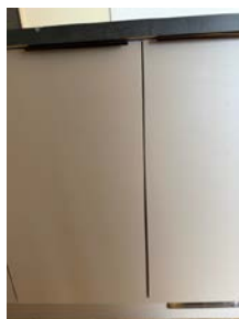
Ujevn spalte mellom skapdører.
