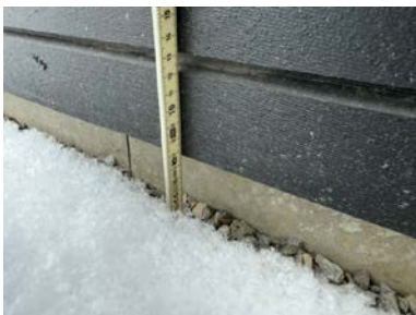
Kledning er avsluttet nærme terreng.
