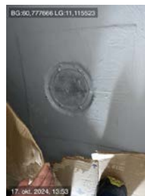
Bilde fra uavhengig kontroll - overgang membran/sluk
