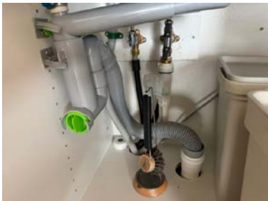
Synlige avløpsør i plast.
