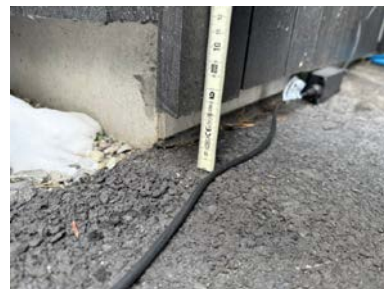
Kledning er avsluttet nærme terreng.
