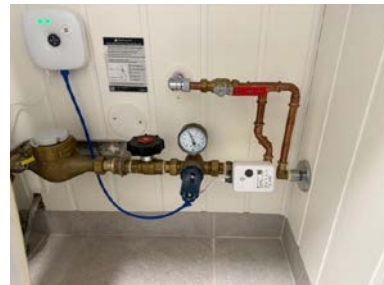
Hovedstoppekran er lokalisert i teknisk rom.
