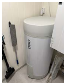
Varmtvannstank er plassert i teknisk rom.
