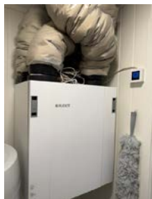
Ventilasjonsaggregat er plassert i teknisk rom.
