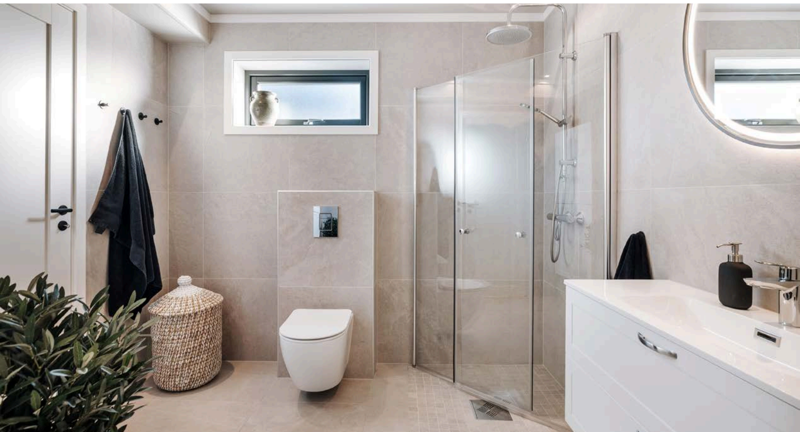
Lekker flislagt bad med elektrisk gulvvarme og downlights i himlingen.
