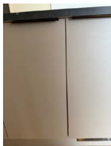
Ujevn spalte mellom skapdører.
