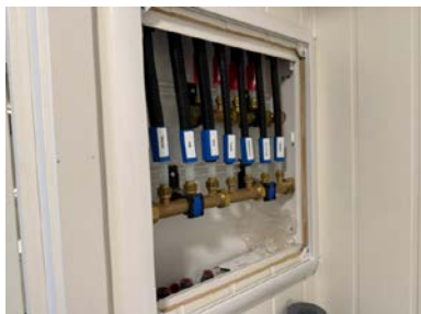
Fordelerskap er lokalisert i teknisk rom.
