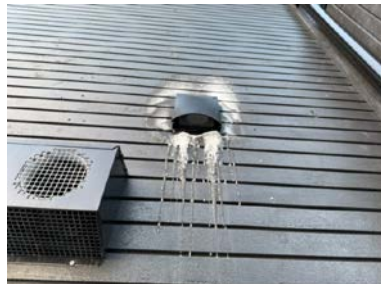
Ventil tilknyttet lufting på avløpsanlegget avsluttet med veggmontert ventil.
