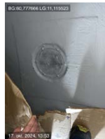
Bilde fra uavhengig kontroll - overgang membran/sluk
