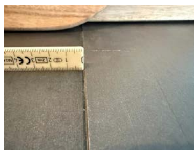
Trapping på skjøt i benkeplate.
