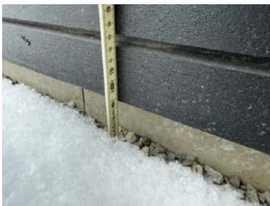
Kledning er avsluttet nærme terreng.
