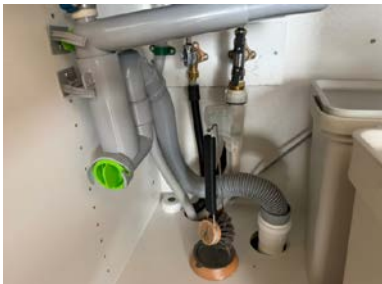
Synlige avløpsør i plast.
