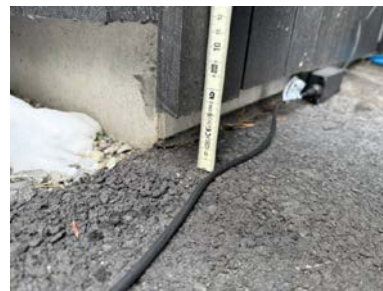
Kledning er avsluttet nærme terreng.
